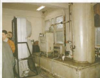
Equipos de hidráulica.
